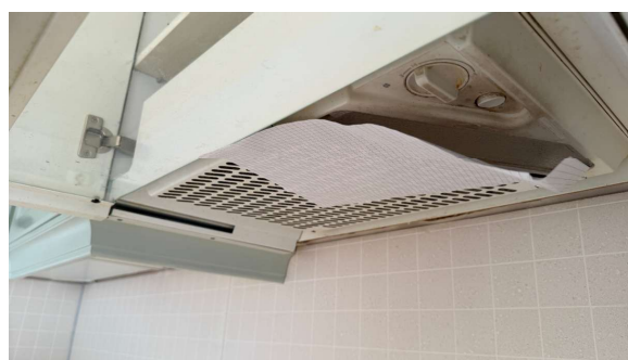
Avtrekkskontroll med papir.
