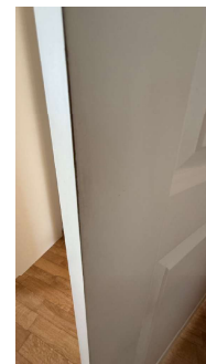
Overflateslitasje på soveromsdør.
