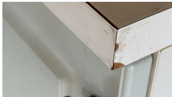
Avskalling på benkeplate.
