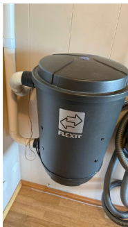
Støvsugermotor i innvendig bod.
